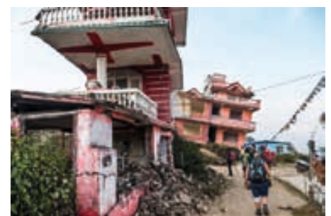
Erdbebenschäden in Chisapani
